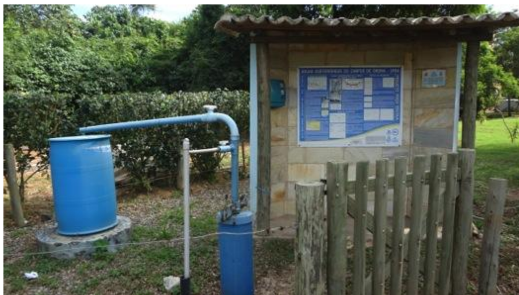
Figura 33. Poço no Campus de Ondina – UFBA: poço com moto-bomba tubular, tanque de água e painel informativo.
