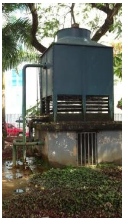
Figura 28. Torre de resfriamento da Reitoria da UFBA, situada fora do Campus (Bairro de Campo Grande). Observam-se perdas de água por evaporação, respingo, e vazamentos.
