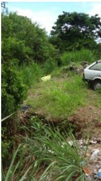
Figura 4. Área erodida no limite do local da EP-UFBA, no acesso do estacionamento inferior.
