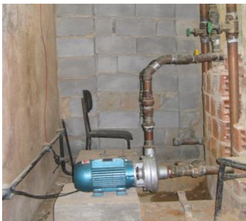
Figura 40. Casa de bombas no 2º andar mostrando uma das bombas e a instalação hidráulica.
