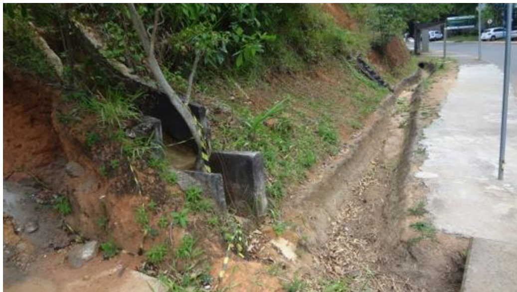
Figura 70. Fim da escada drenante. Campus de Ondina.
