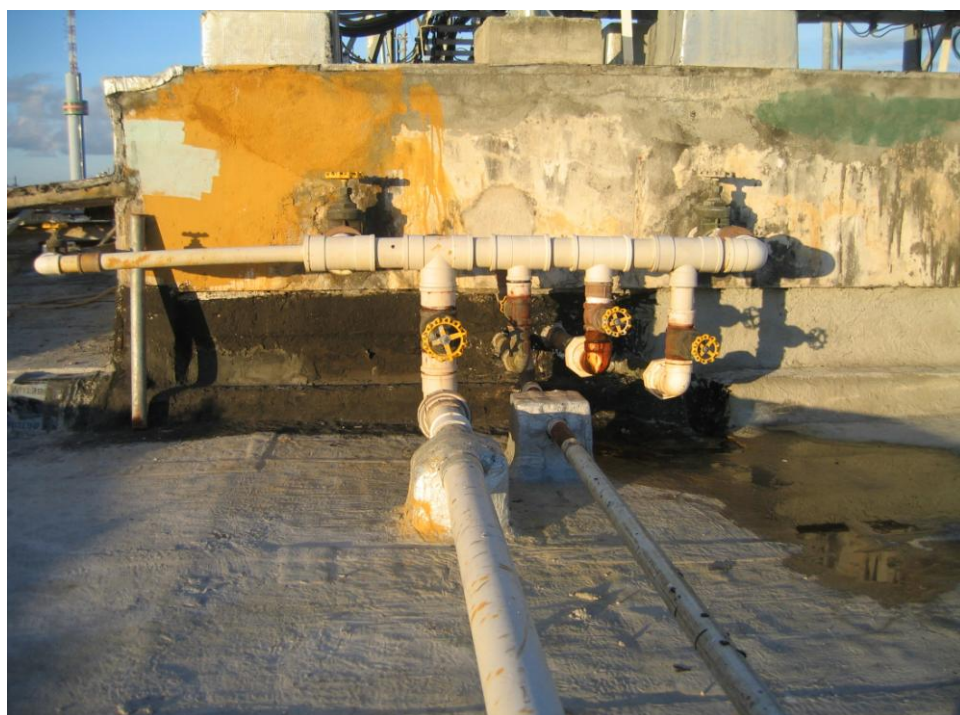
Figura 45. Barrilete de distribuição na saída do reservatório superior.
