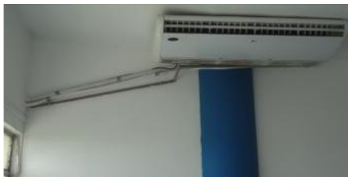
Figura 95. Aparelho de ar condicionado cuja água é reusada. Sala do PEI – Pós-Graduação em Engenharia Industrial, 6º andar.
