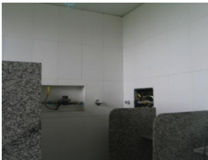
Figura 85. Medição setorizada com transmissão dos dados por sinal 4-20 mA. Banheiro principal masculino, 4º andar.
